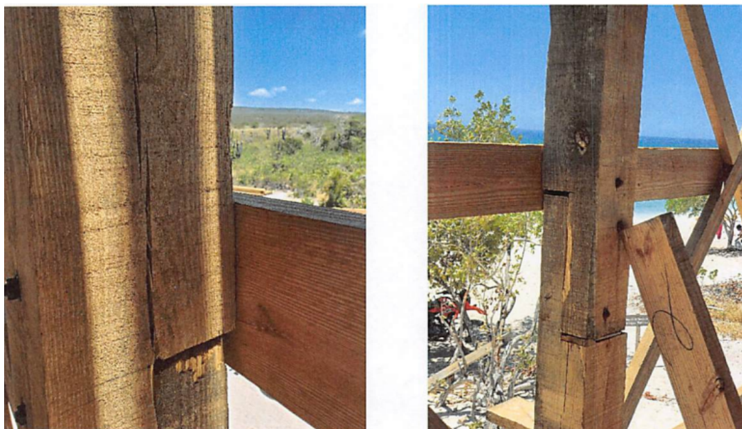
Ilustración 13. Empalmes mal elaborados y fisuras en las columnas, Torre de Observación, playa de Bahía de las Águilas, provincia Pedernales, República Dominicana, agosto 2022.
